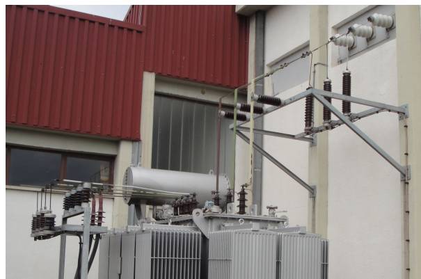
Слика 9.12. Потпорни изолатори кај приклучоци на трансформатор (горе десно се видливи и воведни изолатори со кои се влегува во внатрешноста на постројката)
