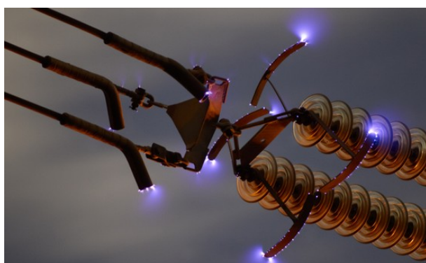
Слика 7.5. Корона на изолаторски ланец од 500 \text{ kV} надземен вод
