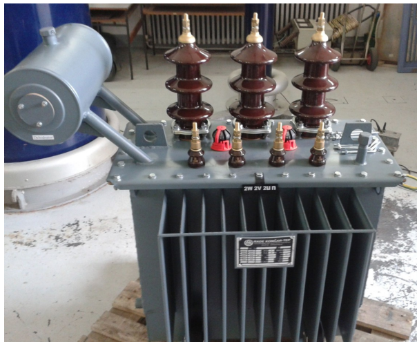
Слика 9.31. Изглед на дистрибутивен трансформатор 10(20)/0,4 kV (во средината се видливи прекинувача за регулација на напон и прекинувача за бирање на примарен напон 10 или 20 kV)
