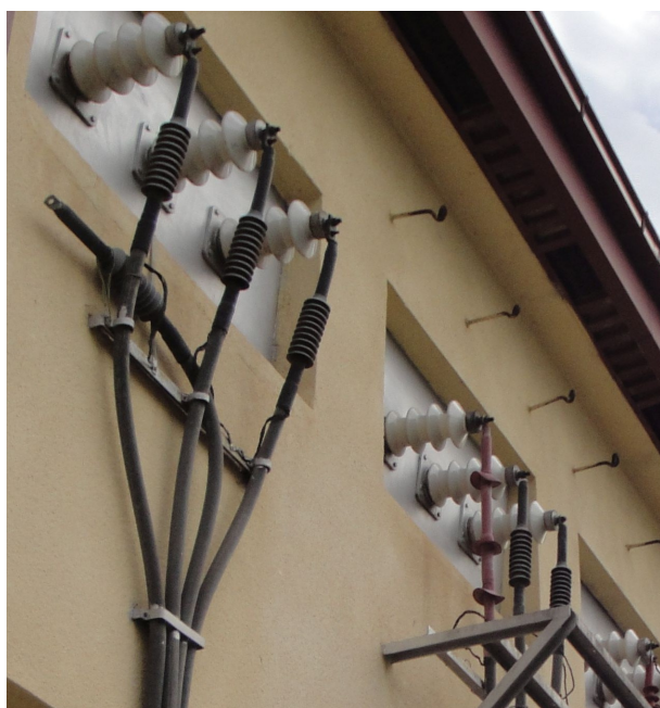
Слика 9.19. Воведни изолатори за влез на кабелски вод во зграда
