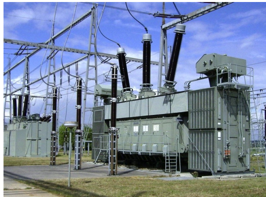
(б) одводник и трансформатор
