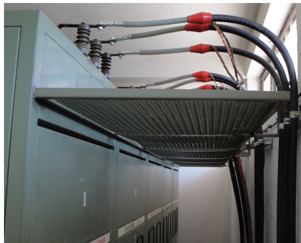
Слика 9.28. Влез на кабел со кабелски завршеток во трафостаница со оклопена ќелија
